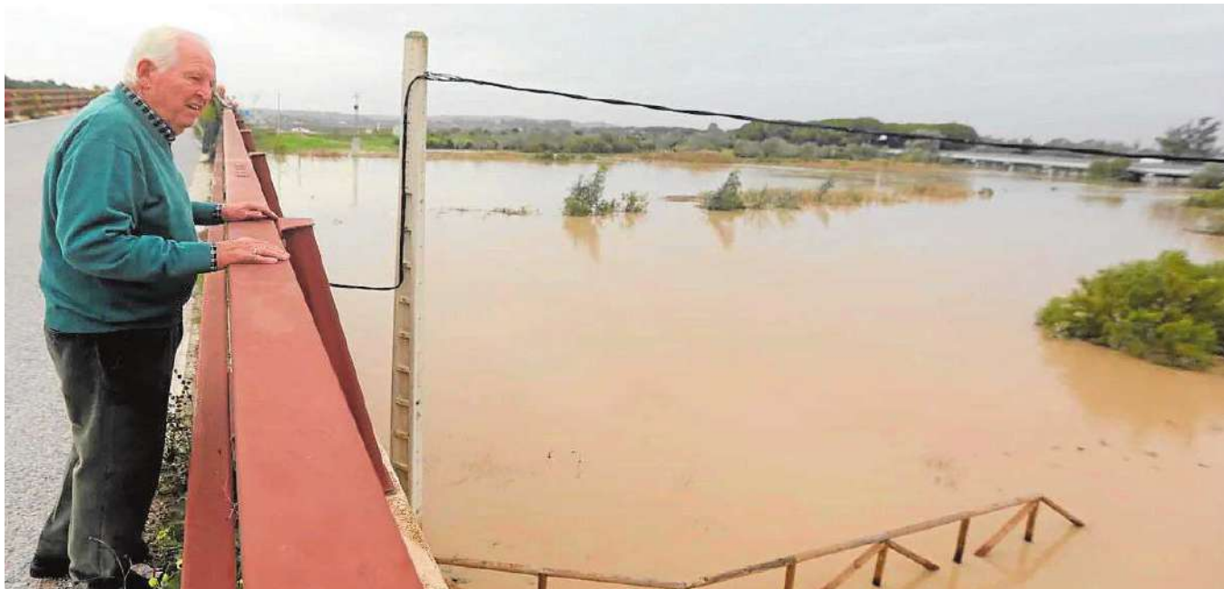
Un vecino de la zona rural de Jerez observa la crecida del Guadalete el pasado año // FRANCIS JIMÉNEZ
