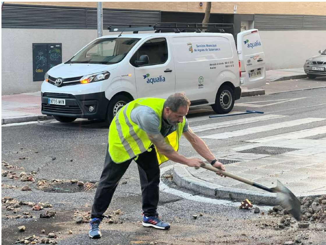
Rotura tubería calle Venezuela
