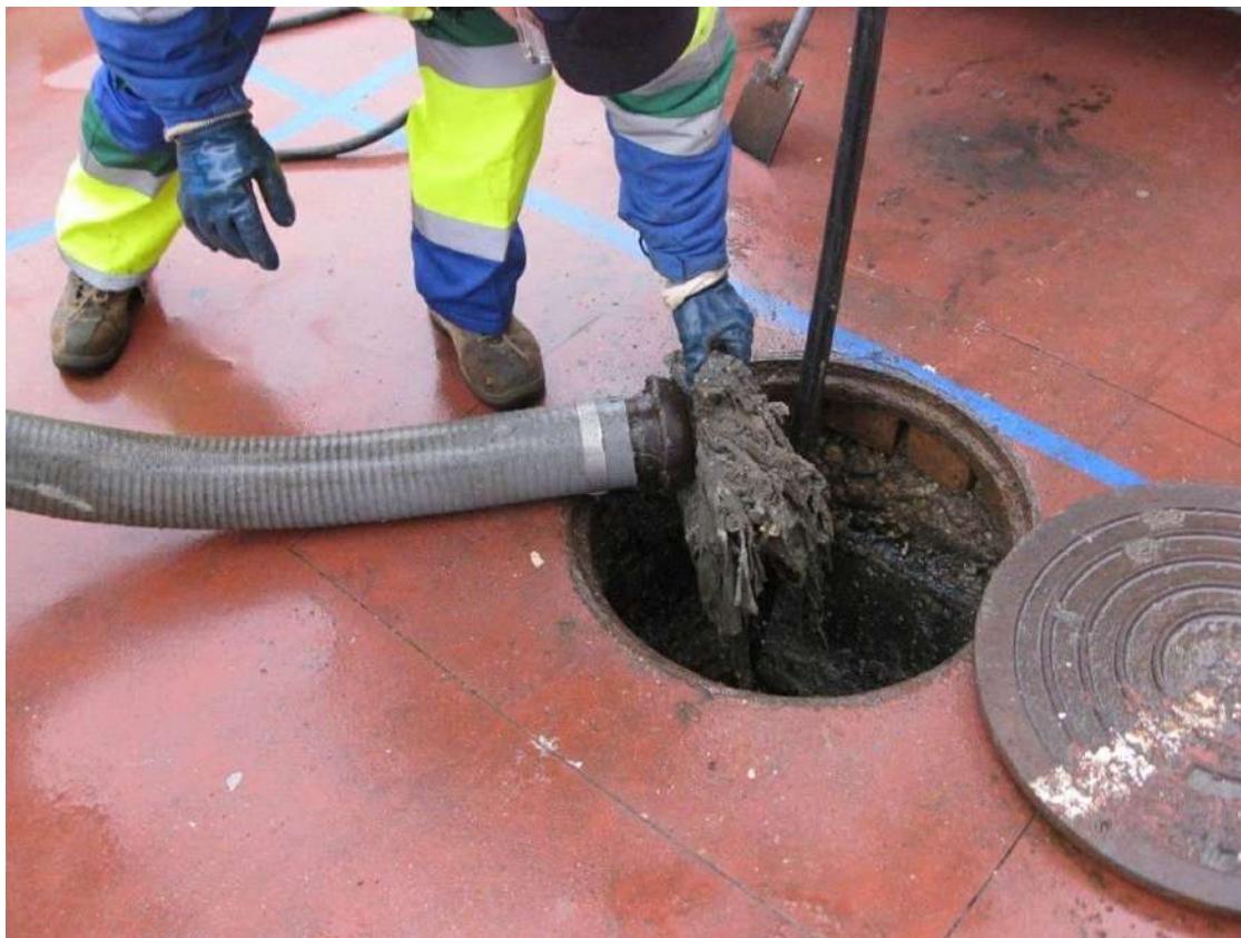
Operarios quitan toallitas del alcantarillado. / DDA
